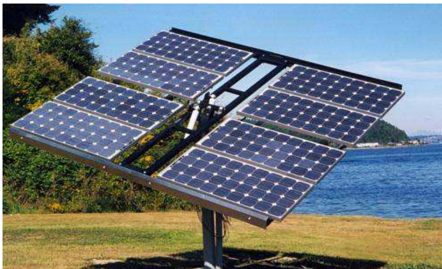
- Painéis Solares de estrutura móvel
