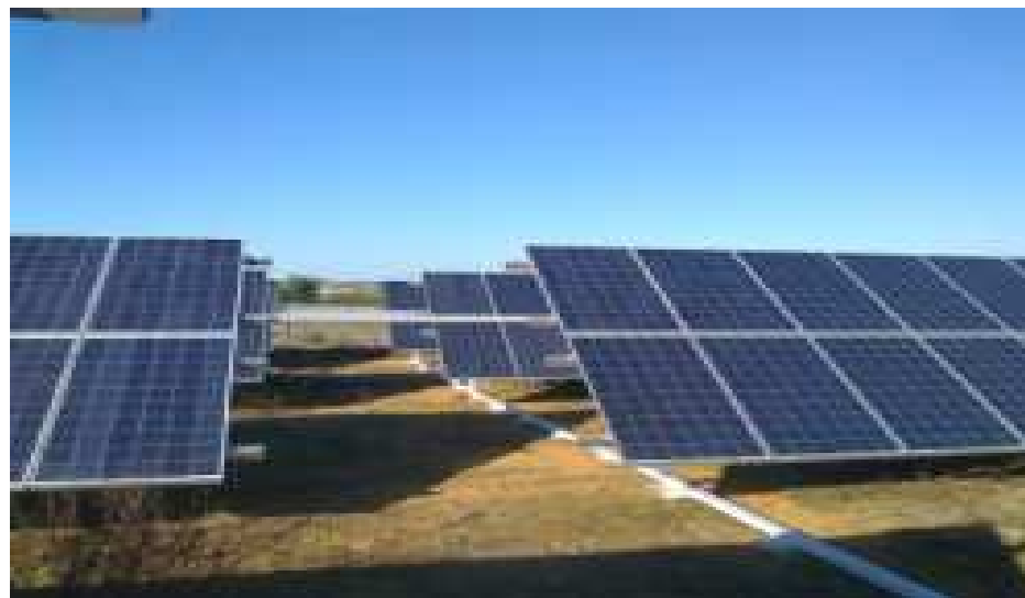
- Painéis Solares de estrutura fixa
